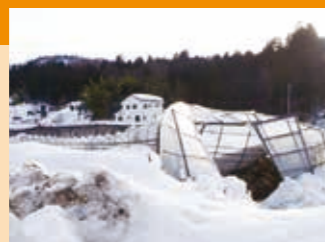
豪雪により倒壊したハウス
