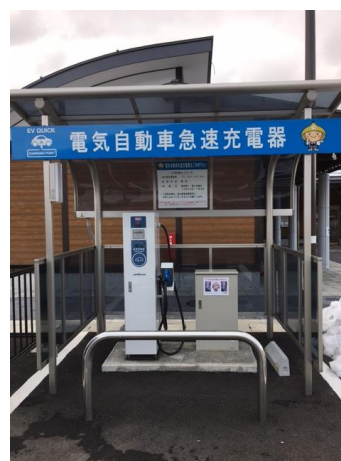
電気自動車急速充電器 （道の駅「禅の里」）
