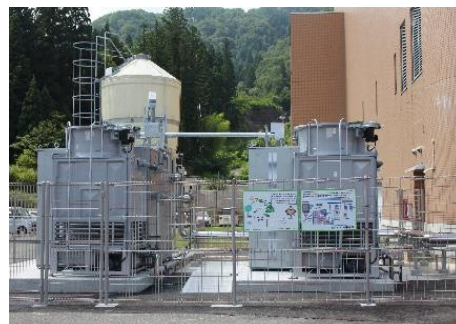
バイオマスボイラー（上志比文化会館）
